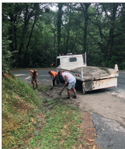
Ramassage de béton renversé par un camion sur la voirie.
