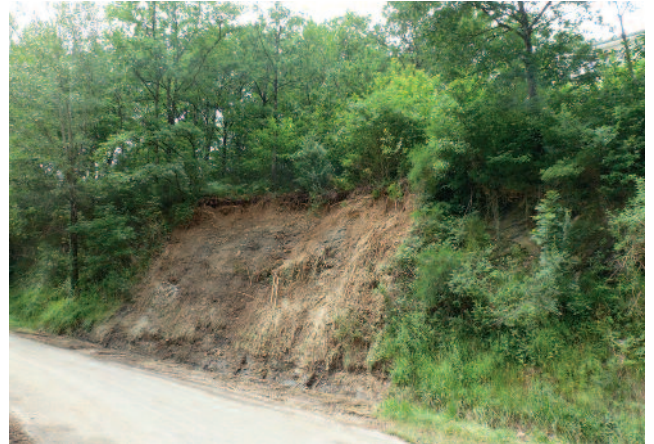
Les pluies ont causé de nombreux glissements de terrains ou d'effondrement de talus
