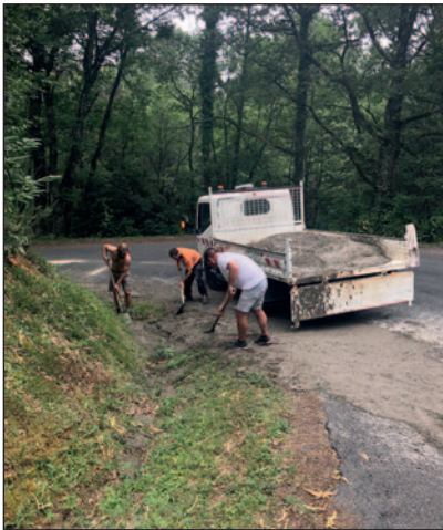
Ramassage de béton renversé par un camion sur la voirie.
